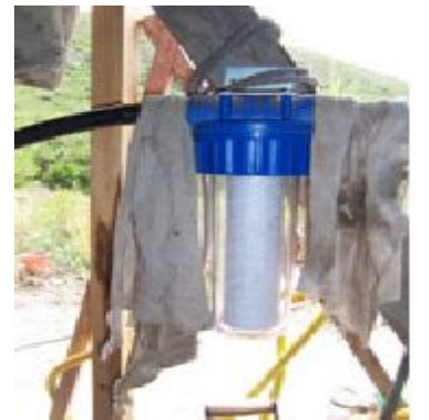
Ilustración: Filtro de piscinas
